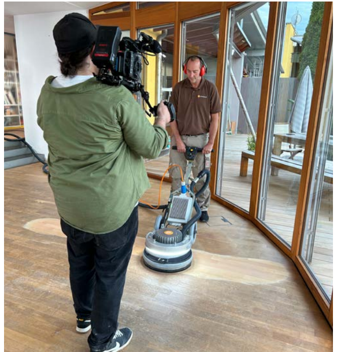
Aus alt mach' neu: Der Boden wurde zunächst mit der PALLMANN SPIDER abgeschliffen.
